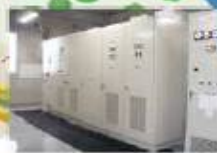
照明制御受変電システム
