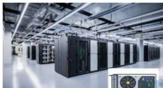
AIサーバー設置
