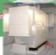
非常用発電設備
